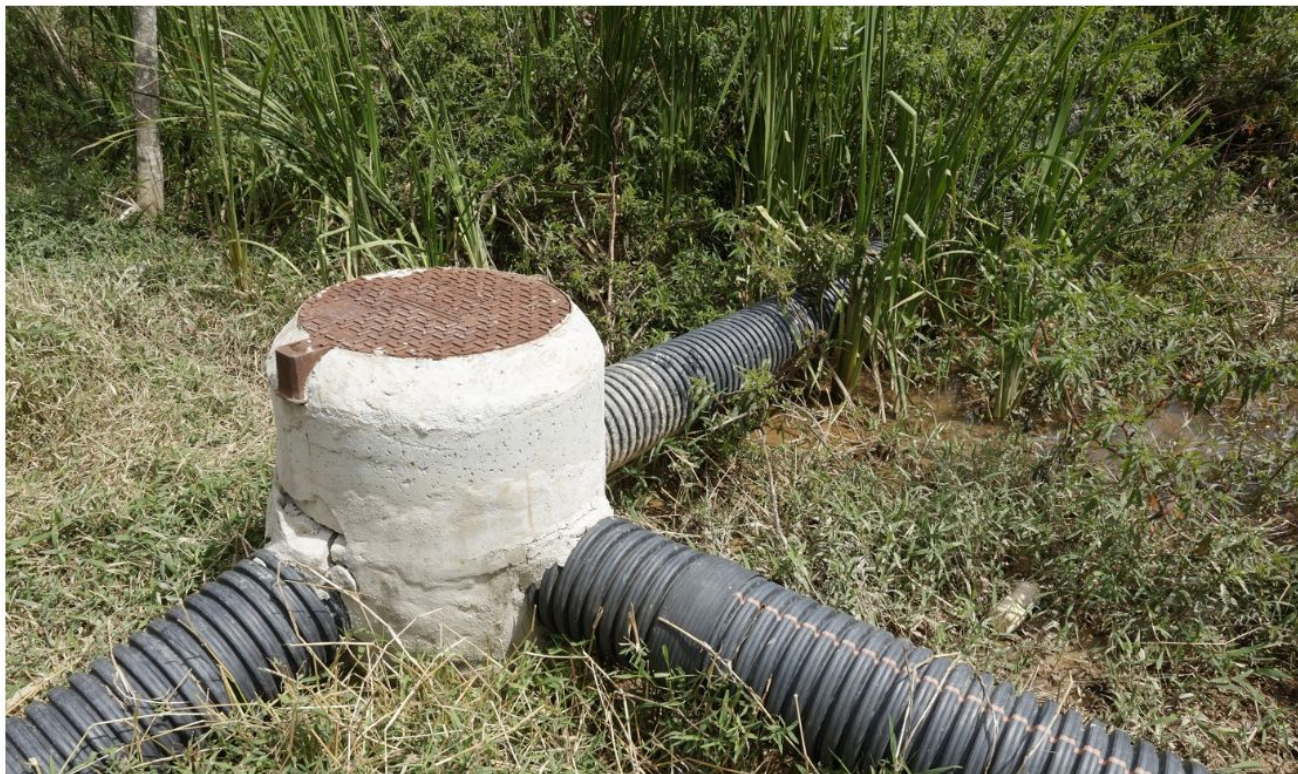
Foto 2: Tubos de esgoto próximos às nascentes.
