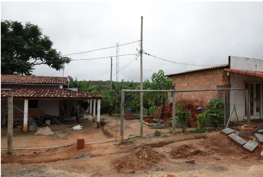
Ligações irregulares de energia na Comunidade São Miguel.
