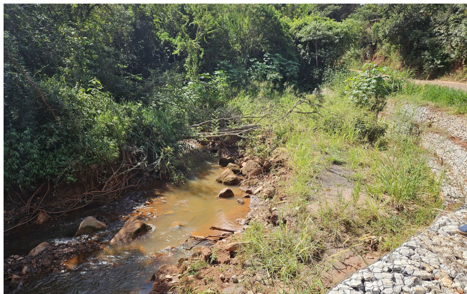
Figura 3: Margens do Córrego Samambaia
