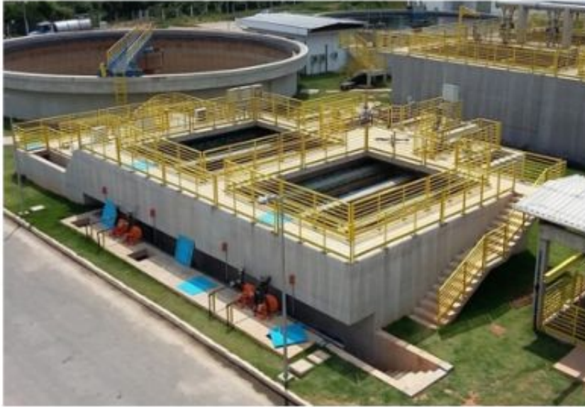
Estação de Tratamento de Esgotos – ETE Ibirité
