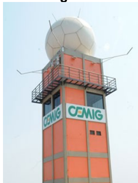
Figura 15 - Radar meteorológico instalado em Mateus Leme
